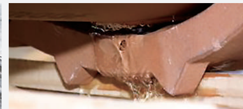
普通勾用配瓦は漏水しています
